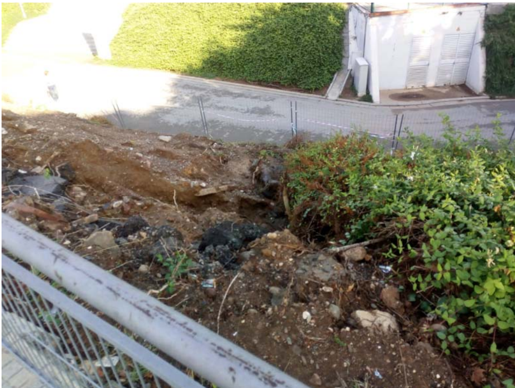
Vista de l'erosió sota la geomalla encara existent al costat de l'esslavissad
