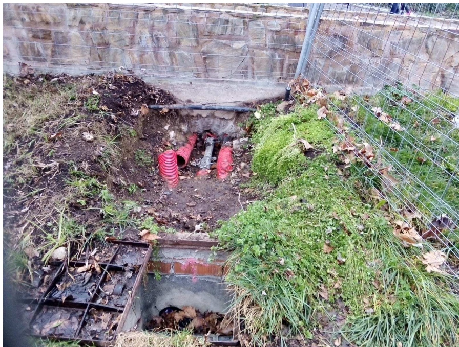
Foto 2. Tub de reg sota el canal on hi ha la fuga d'aigua.
