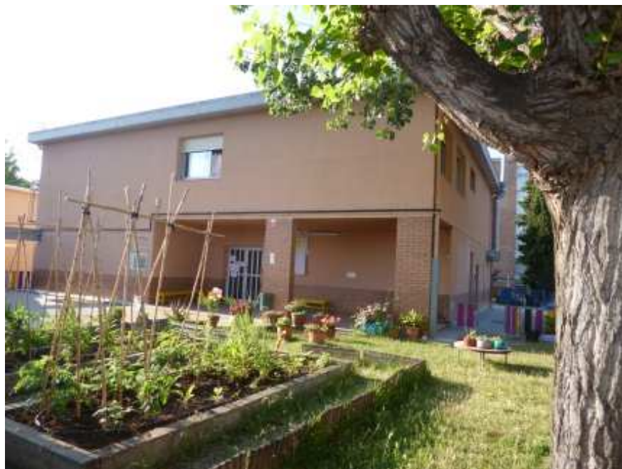
Façana a reparar
