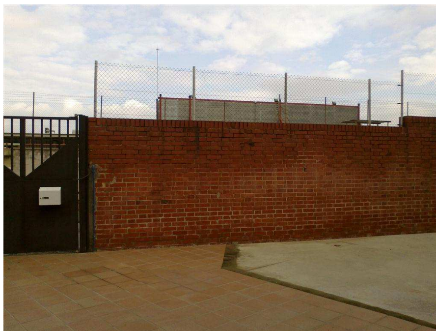
Mur a reforçar
